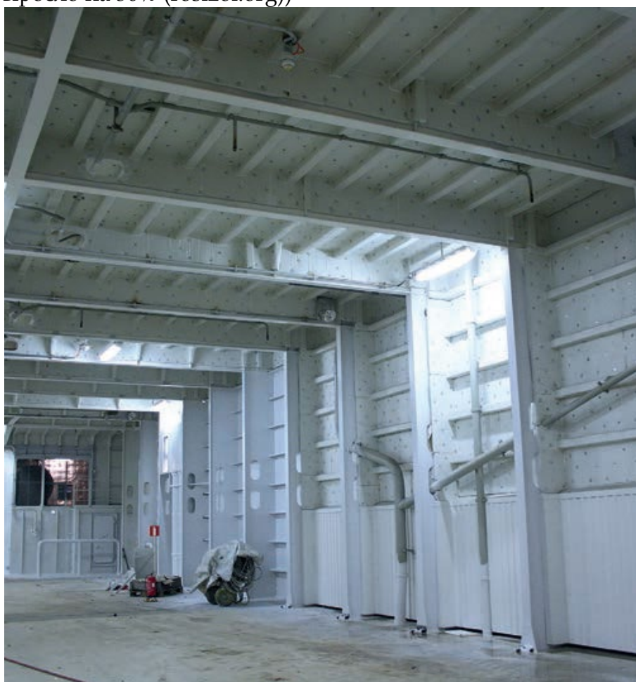
Рисунок 1 – Изолированное судовое помещение Судовая изоляция позволяет обеспечивать:
