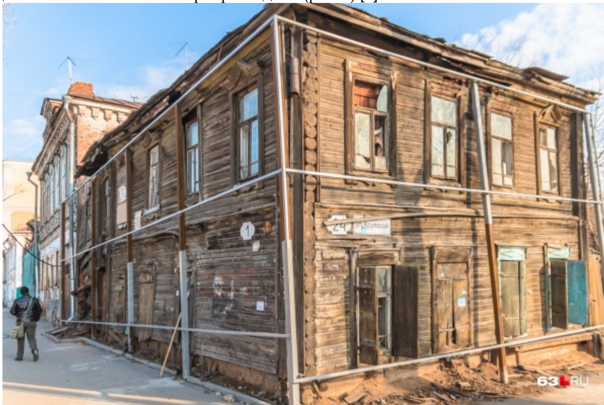
Рисунок 4 – Пример аварийного здания в г. Самара
